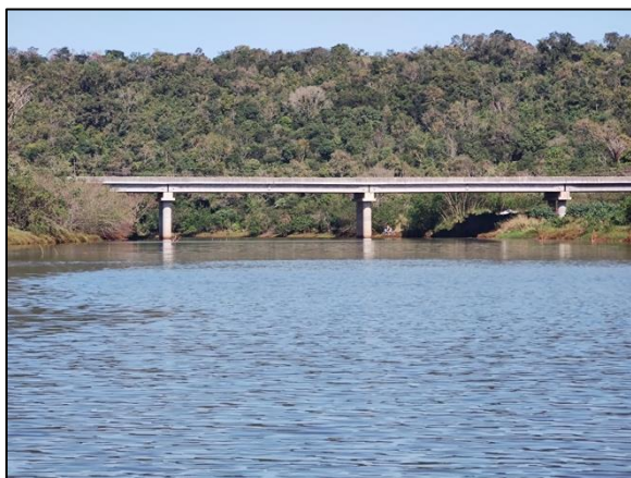
Foto 102 – Reservatório rio Andrada - Tratamento
